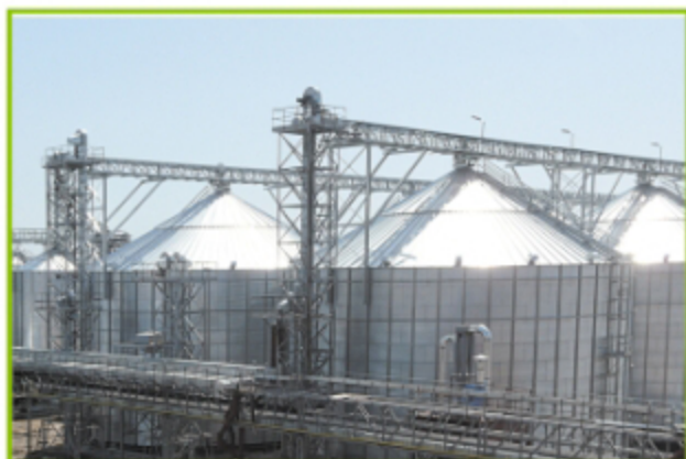
Транспортное оборудование SKANDIA ELEVATOR (Лиски, Воронежская область)
